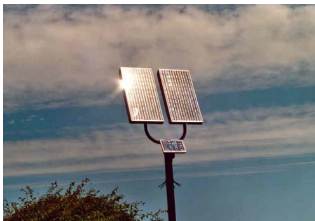
Zonnepanelen zorgen voor de energie van het markeringssysteem. Met het kleine zonnepaneeltje wordt een bestaand telsysteem voor het meten van de verkeersintensiteit op deze locatie gevoed.
